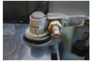
亀裂が入ったターミナル
