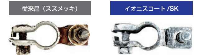
従来品(スズメッキ) イオニスコート/SK ボルトナット部分から発生した赤錆が本体に移行している。 白く見えるのは塩水噴霧による塩で錆は発生していない。 ※本試験は当社独自の定めに基づき行った試験であり、実際の使用においてその評価を適用することはできません。
